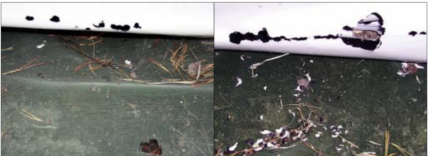
Abbildung 4: Nageschäden durch Mäuse an der Folie und am eigentlichen Mäuseschutzgitter
